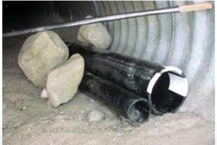
Hình 4. Cổng có hai công dụng/Lối chui dưới đường cho động vật hoang dã
