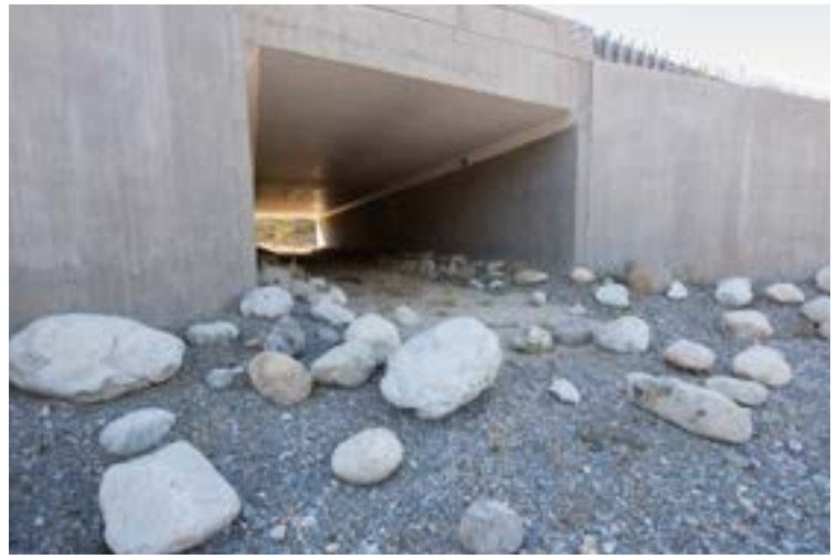
Hình 3. Lối chui dưới đường cho động vật hoang dã điển hình
